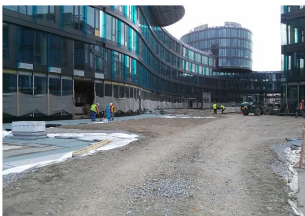
Další vrstva na POROFLOW RF –asfalt. penetrace, izolační pásy, polystyrenové desky, geotextilie, vhodná zemina nebo štěrkový zásyp.
