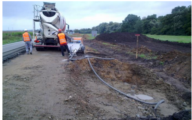
Zaplnění nefunkčního potrubí pod úrovní terénu
